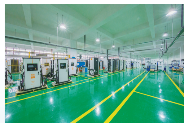
浙江万马新能源有限公司自主研发的新能源汽车直流充电桩,突破了线上线下一体化运营难题。
