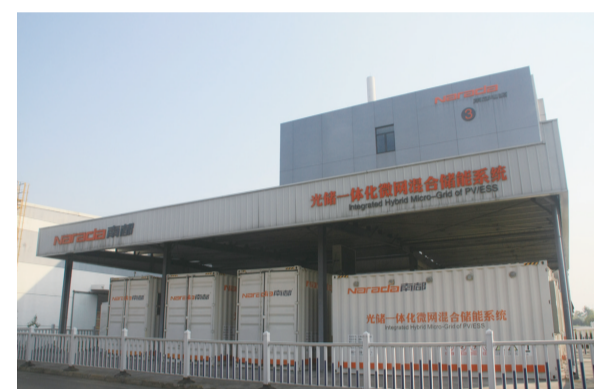
浙江南都电源动力股份有限公司国内首创的光储一体化微网混合储能电站,实现了多种储能优势互补,解决了新能源并网中风电、光电投资浪费问题。
